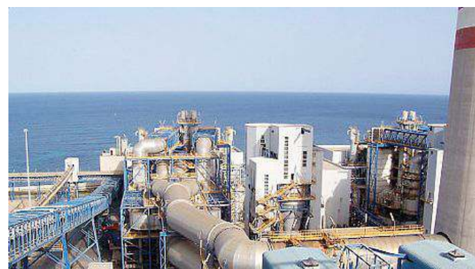
I filtri del desolfuratore della centrale di Fiume Santo
